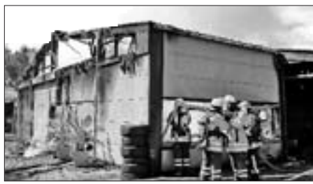
Ausgebrannt: Die Lagerhalle bei Burgdorf. Elsner
